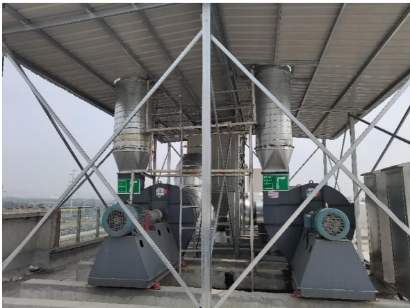
左侧为焊接烟尘处理设备，右侧为有机废气处理设备 及排气筒
