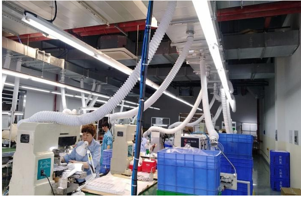
移印车间集气管道布置（每个工位均设置了一根集气软管，共 19 根）
