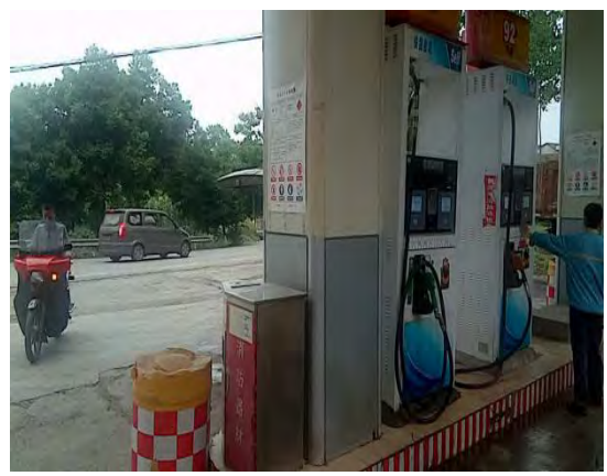
加油机和消防设施
