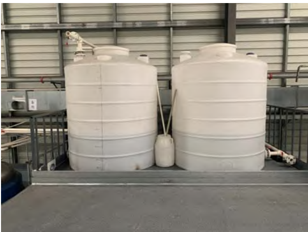
固体外加剂中间产品暂存区及围堰
