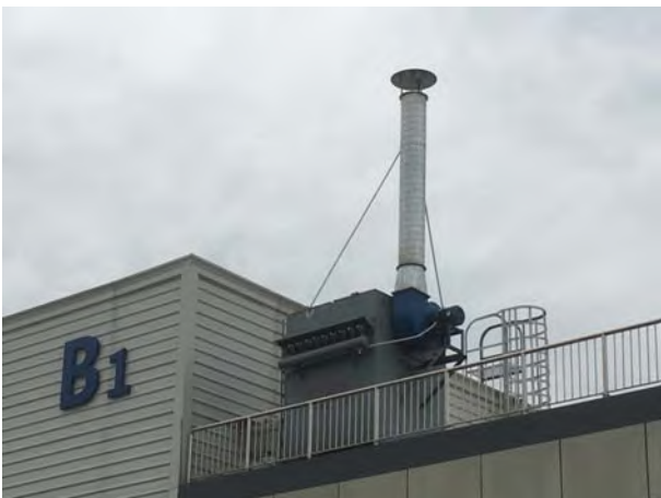
布袋除尘器及排气筒
