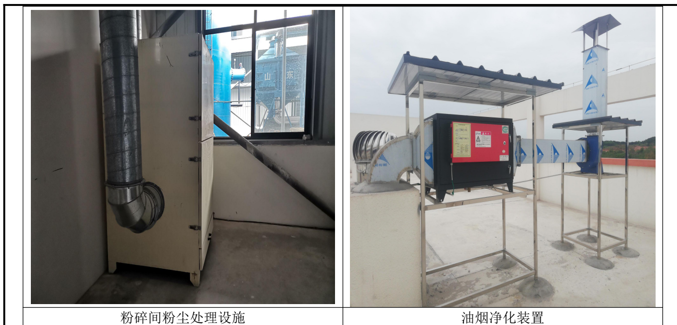
图 3-2 废气处理设施图片
