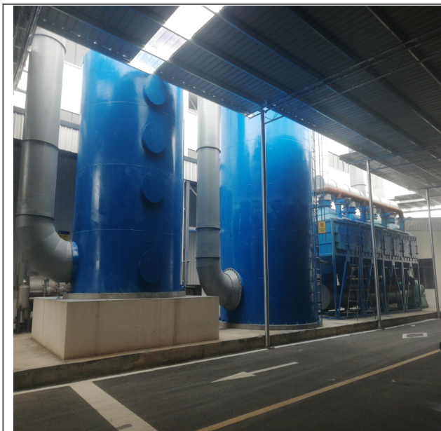
有机废气处理设施
