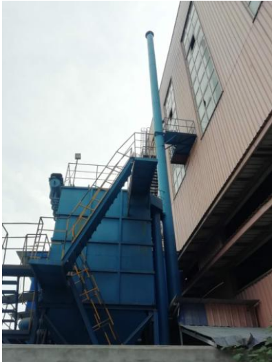
布袋除尘器及排气筒
